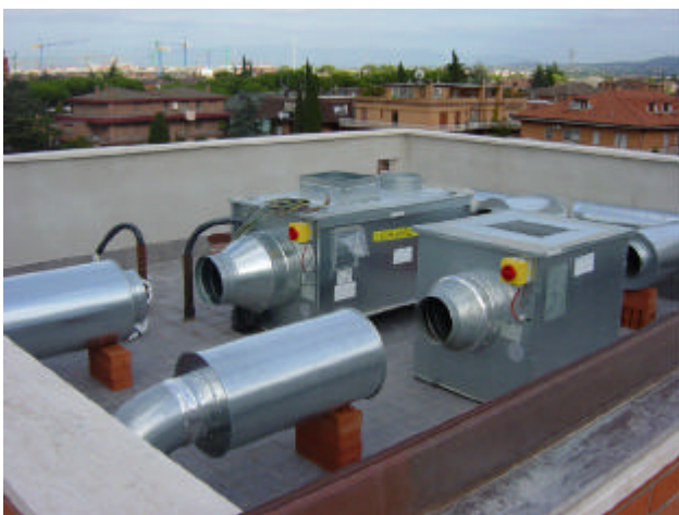
Foto 4 c: elettroventilatori a tetto
